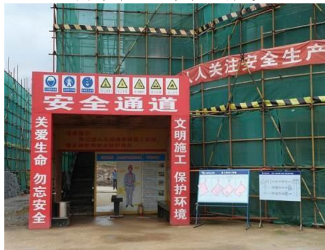
脚手架安全通道
